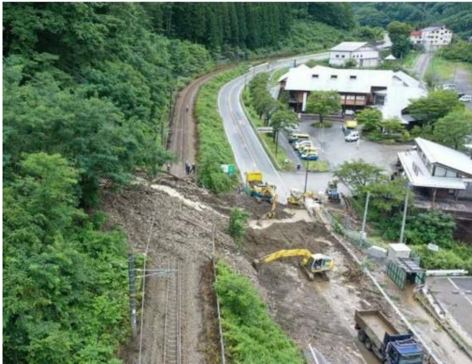
①16日 中央線 木曾平沢駅～贅川駅間の状況
