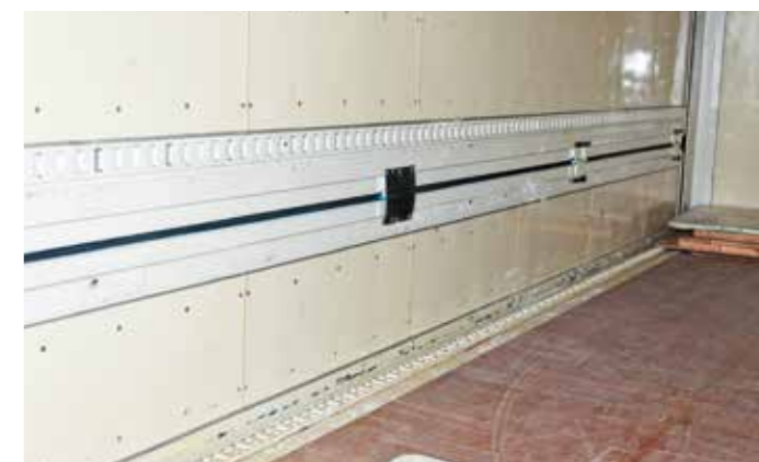
コンテナ床面に敷設されたラッシングレール
