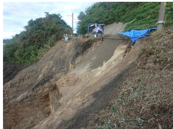
羽越本線村上駅～間島駅間 被災箇所復旧作業状況 9月24～25日撮影 JR東日本新潟支社提供
