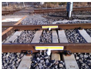
輪重測定装置
