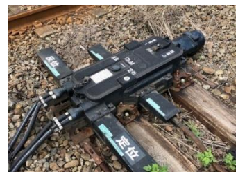
耐水形電気転てつ機
