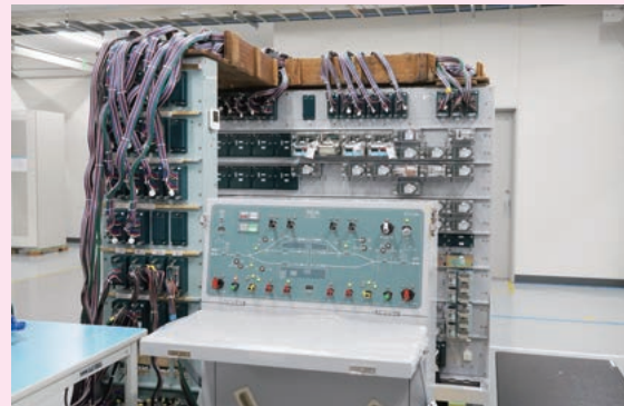
本社工場で完成検査中の継電連動装置
