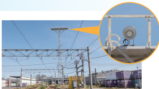
東京貨物ターミナル駅のLED照明
