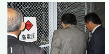
1 電気設備点検(日本運輸倉庫(株))
