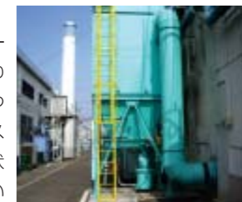
大宮車両所のアスベスト対応集じん装置
