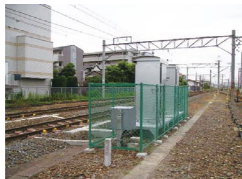
フラット自動検出装置(吹田信号場)
