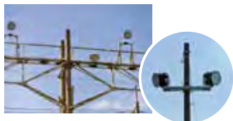
東福山駅構内に設置したLED照明
