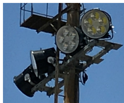
LED照明（東福山駅）
