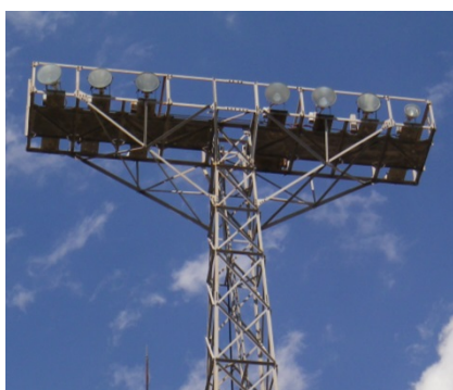
水銀灯照明（東福山駅）
