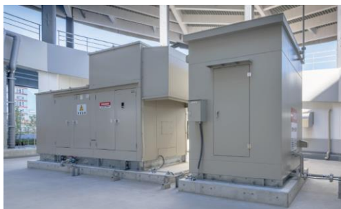
非常用発電機
