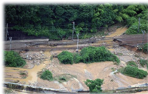
図7 平成30年7月豪雨による山陽本線の被害 参考文献17)より引用
